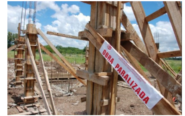
Obras paralisadas Acórdão 1079/2019
