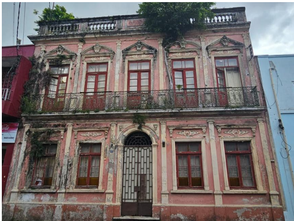
Figura 7 - Palacete Joaquim Américo Guimarães, localizado no centro histórico de Paranaguá (PR), evidenciando danos estruturais decorrentes da falta de manutenção após a desocupação do imóvel.
