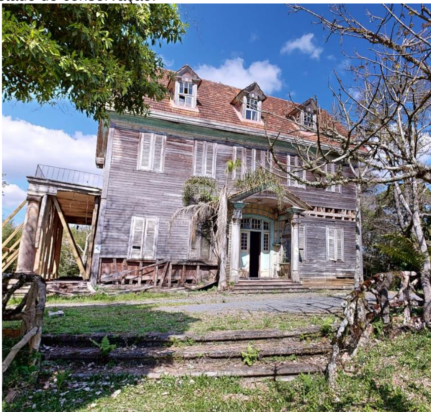
Figura 5 - Palácio do Pinho, localizado no município de Irati (PR), edificação histórica em madeira atualmente em avançado estado de deterioração estrutural.
